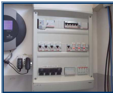
Q.E. Impianto fotovoltaico (lato AC)
