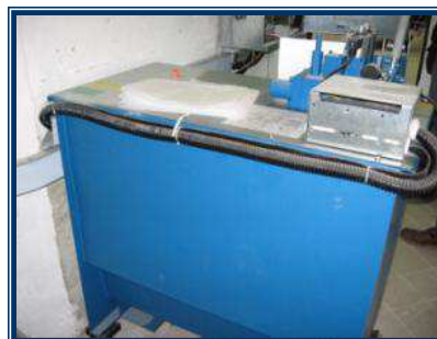
Locale tecnico ascensore
