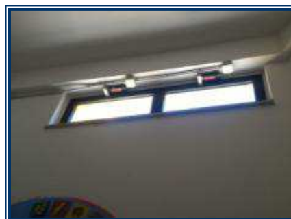
Infisso con sistema di apertura automatica
