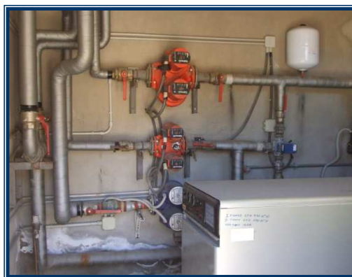
Locale centrale termica
