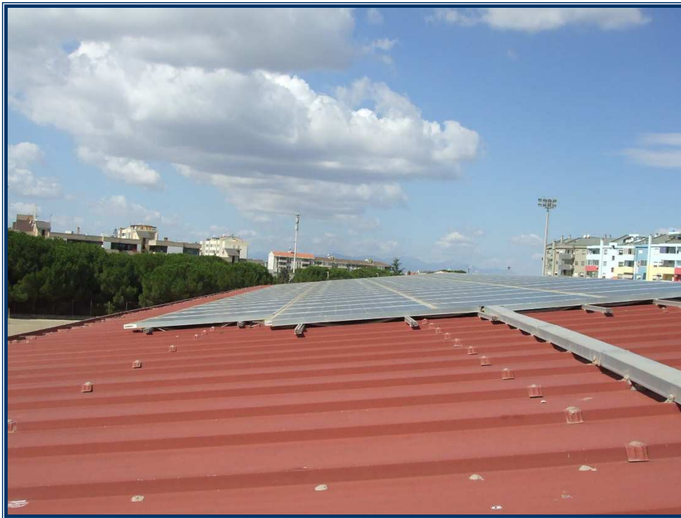
Impianto fotovoltaico esistente.
