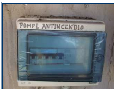
Q.E. Pompe Antincendio in vano bordo Lotto
