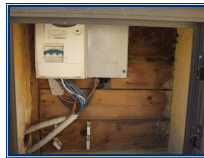
Interruttore principale ENEL in vano bordo Lotto
