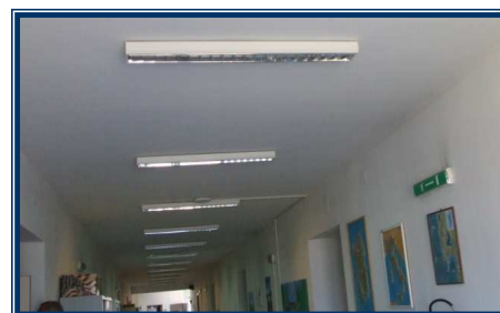
impianto di illuminazione luci d'emergenza dei corridoi scariche o non funzionanti
