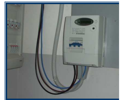
Contatore impianto fotovoltaico
