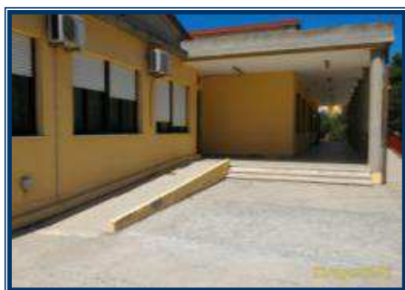
Rampa di accesso senza parapetto lato uffici
