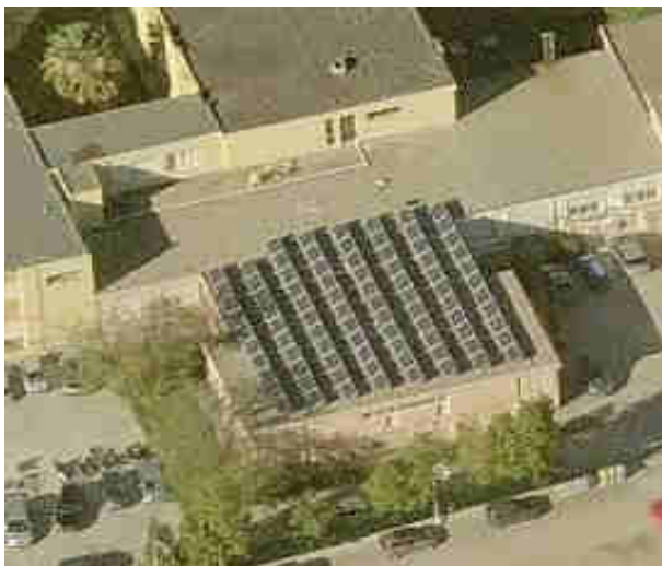
Fig.1: Impianto fotovoltaico su copertura
