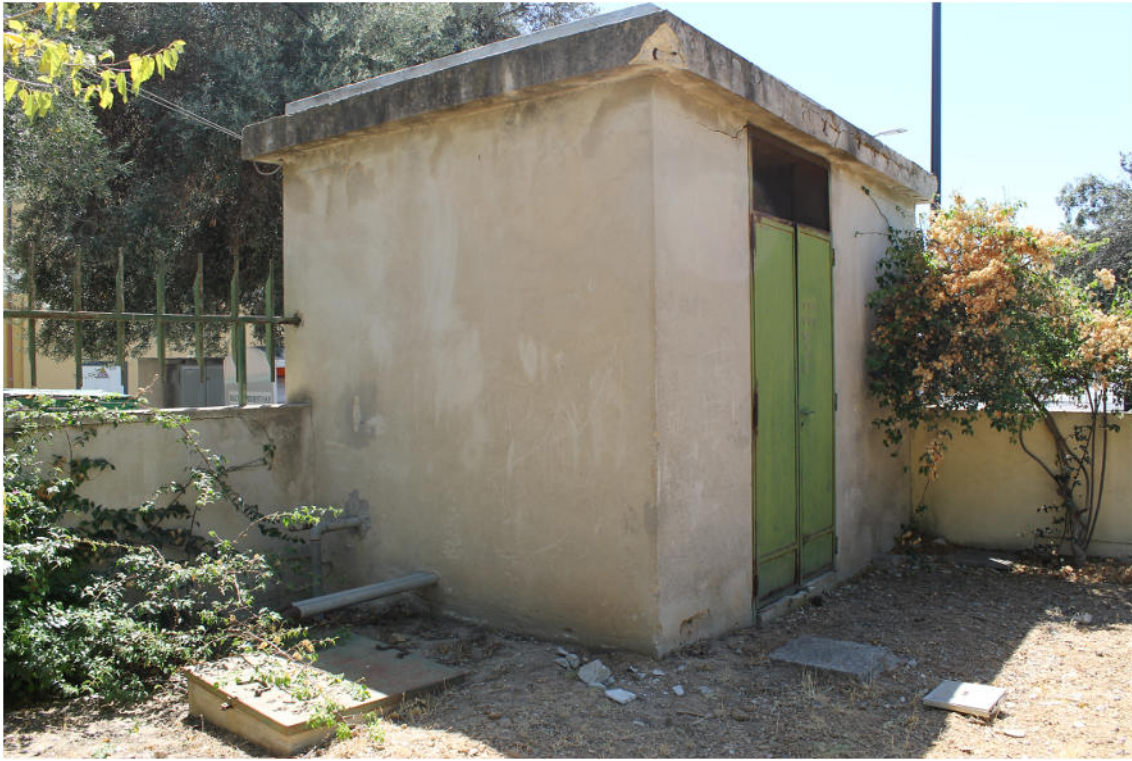
Foto 23: risanamento dei cornicioni del locale autoclave mediante rimozione della parte ammorata di cls, trattamento passivamente del ferro, ricostruzione volumetrica del copriferro, rasatura e tinteggiatura finale.
