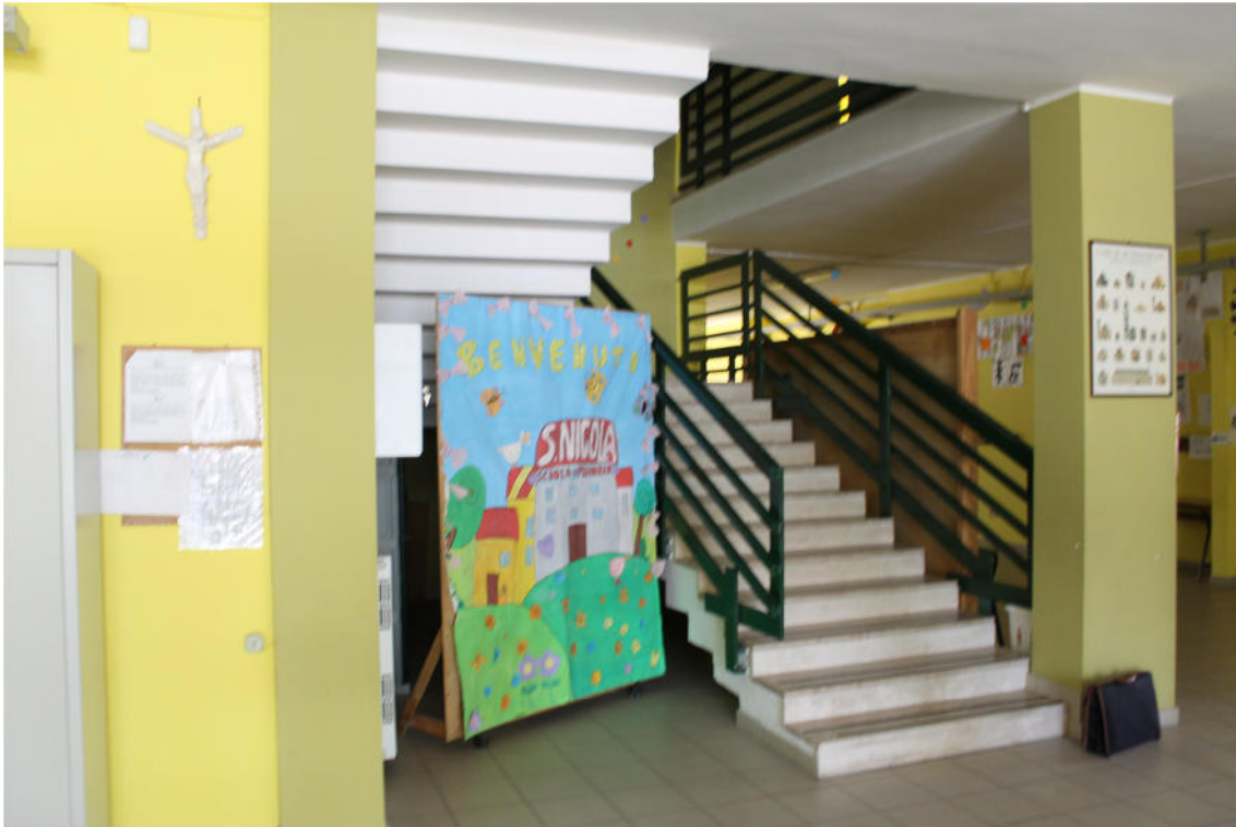
Foto 9: parapetto scala interna da adeguare mediante infittimento dei correnti e montanti (notare lo spazio vuoto esistente)
