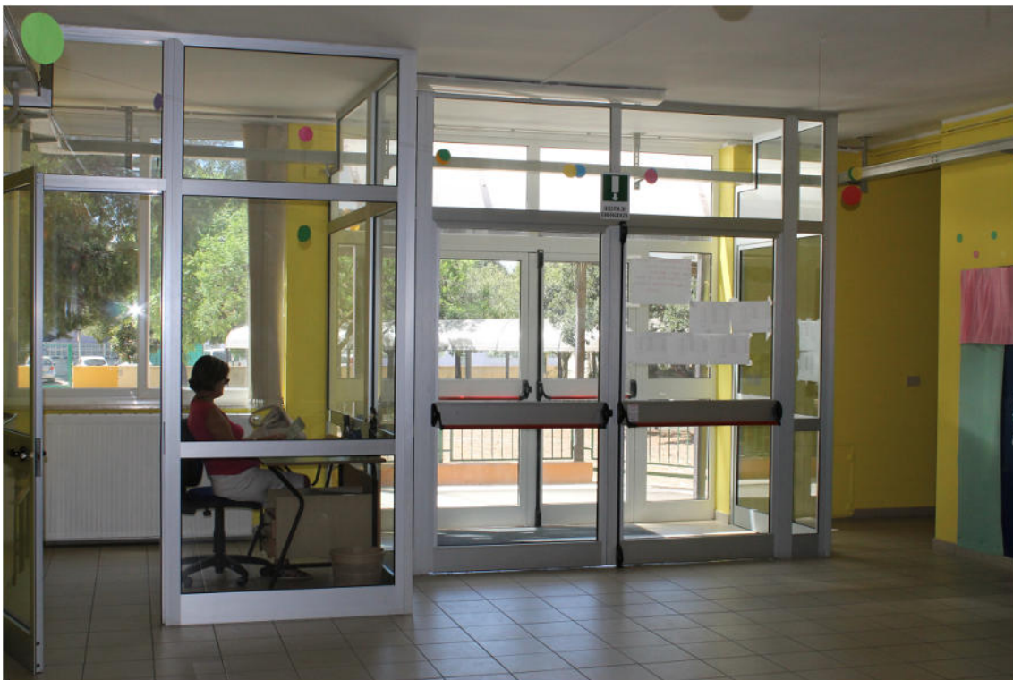
Foto 13: maniglioni da sostituire
