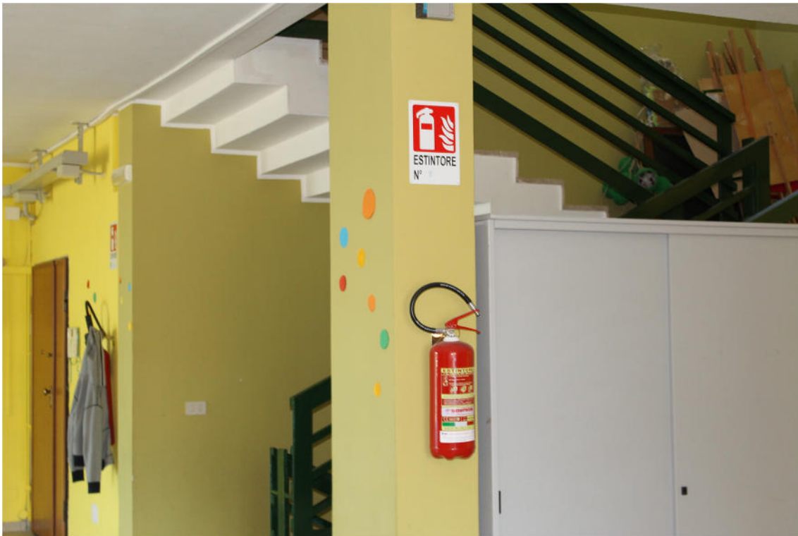
Foto 3: ubicazione nuovo idrante (uno per piano)
