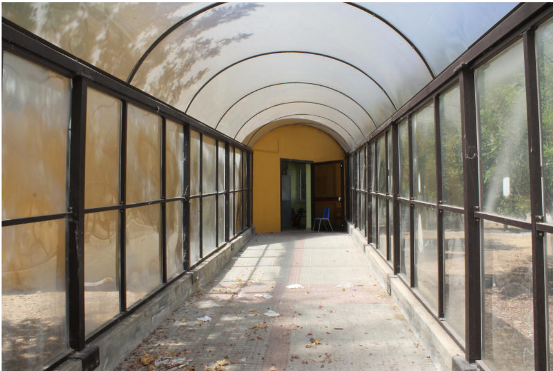
Foto 18: tunnel posteriore lato palestra con chiusura in plexyglass da rimuovere interamente, sostituzione solo di quella di copertura con policarbonato in classe1 e adeguamento del parapetto laterale mediante infittimento dei montanti e correnti
