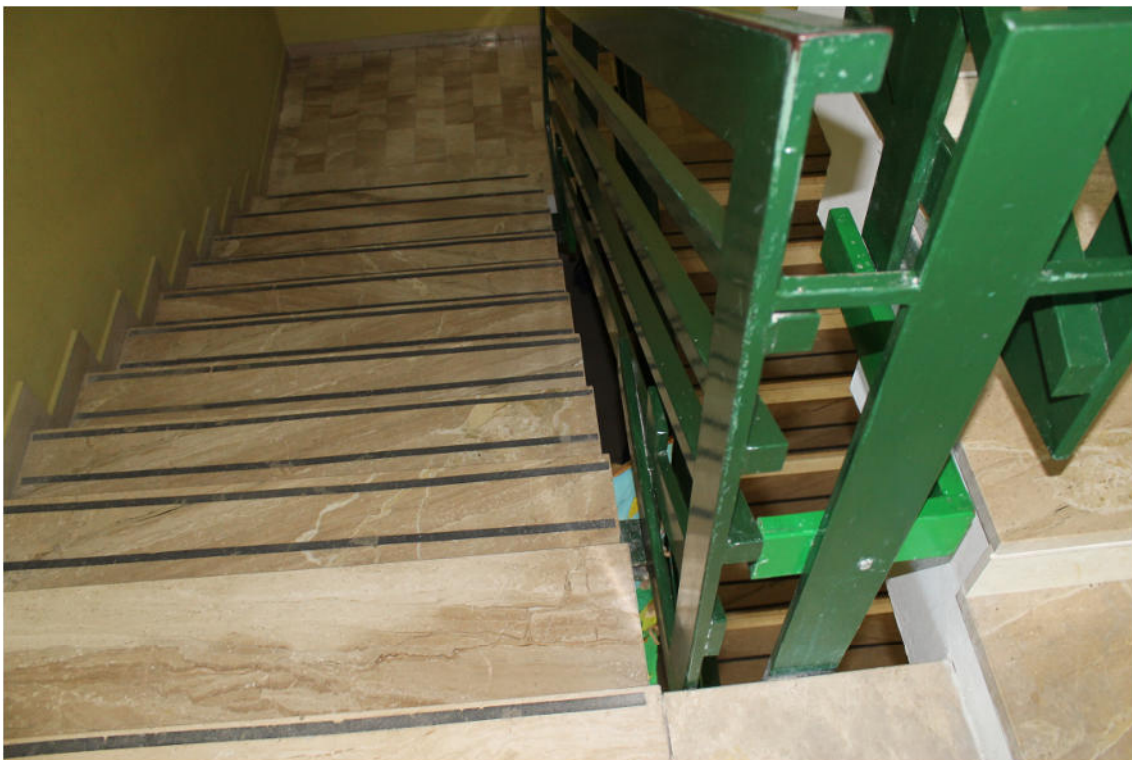
Foto 8: parapetto scala interna da adeguare mediante infittimento dei correnti e montanti (notare lo spazio vuoto esistente)
