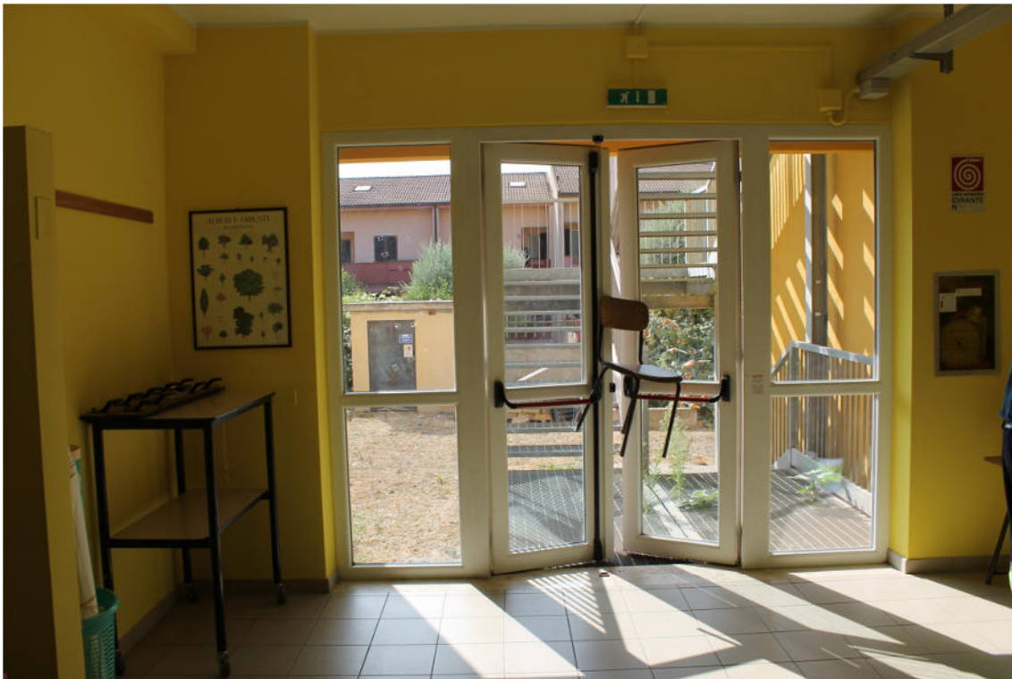
Foto 16: maniglioni da sostituire
