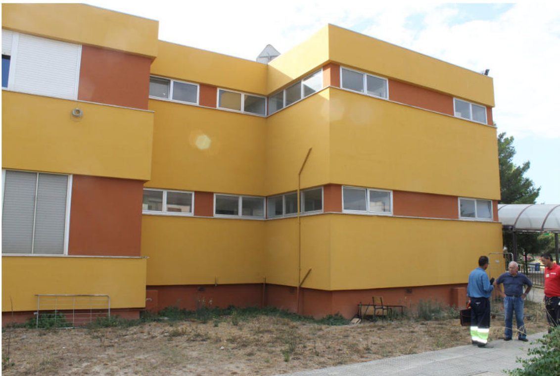
Foto 10: vista da terra del perimetro del lastrico solare su cui installare i parapetti metallici
