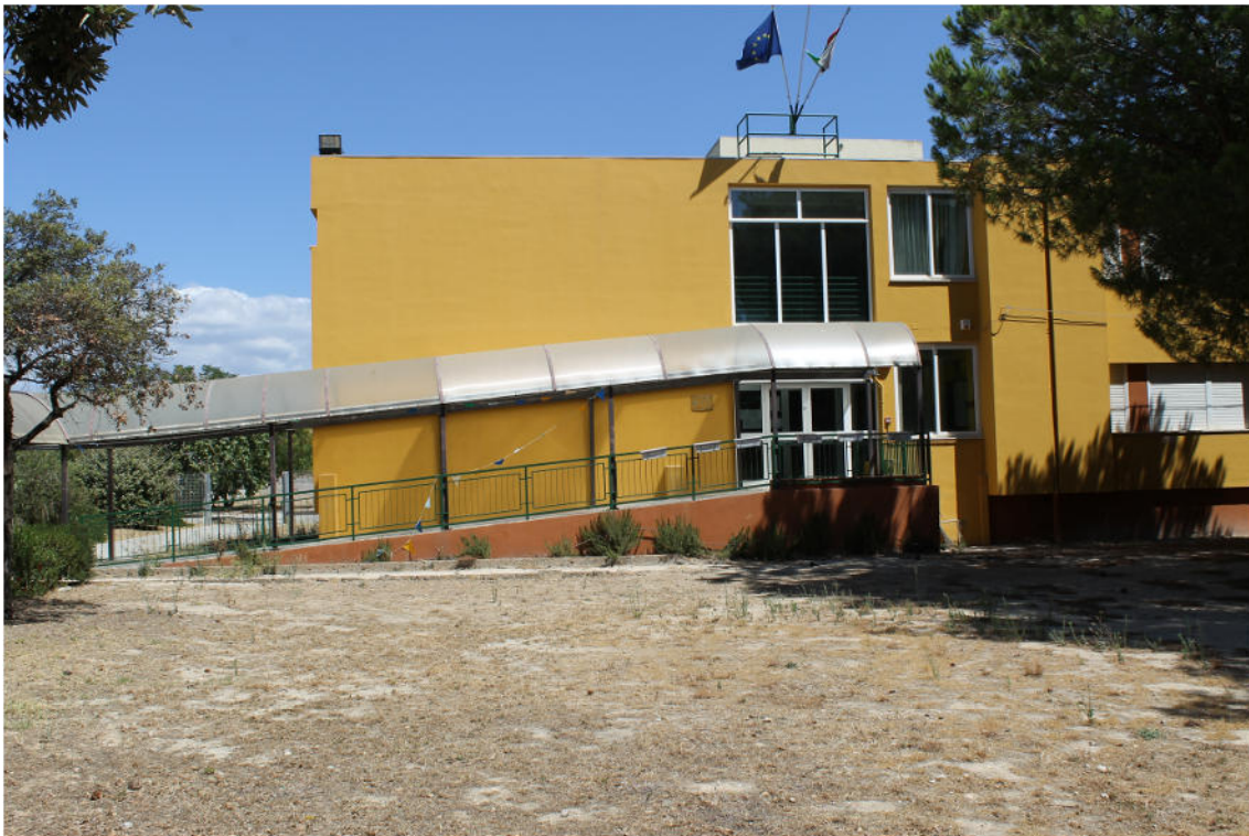
Foto 20: tunnel anteriore lato ingresso principale con rampa. Dettaglio della copertura in policarbonato da rimuovere interamente e sostituzione con policarbonato in classe1. La rampa dovrà essere risanata mediante asportazione del cls esistente, rifacimento massetto e posa pietrini di cemento
